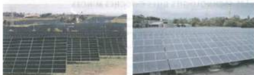
Photo 2 : Installations fixes au sol (Source : Guide de l'étude d'impact pour les installations photovoltaïques au sol 2011)
