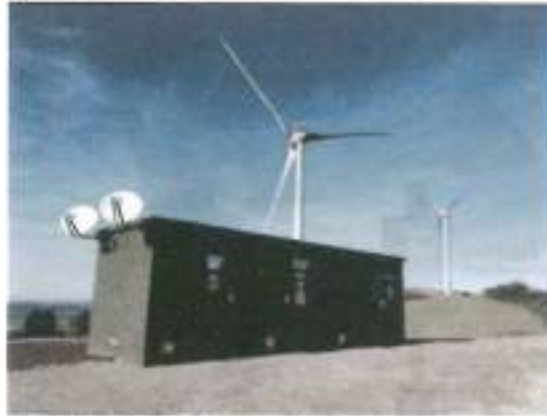
Figure 42 Poste de livraison
