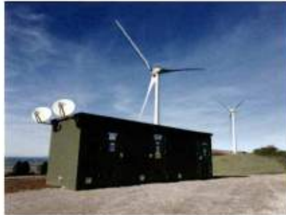
Figure 42 Poste de livraison
